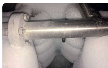
Abb.: Kondensator mit Eisbelegung
